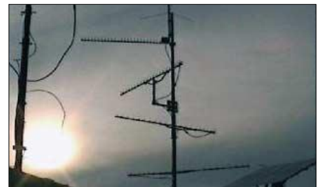
Linkantennen bei DB0ABB in München
